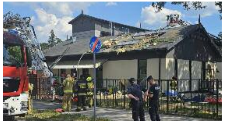
W wyniku pożaru zniszczeniu uległa instalacja fotowoltaiczna i dach
